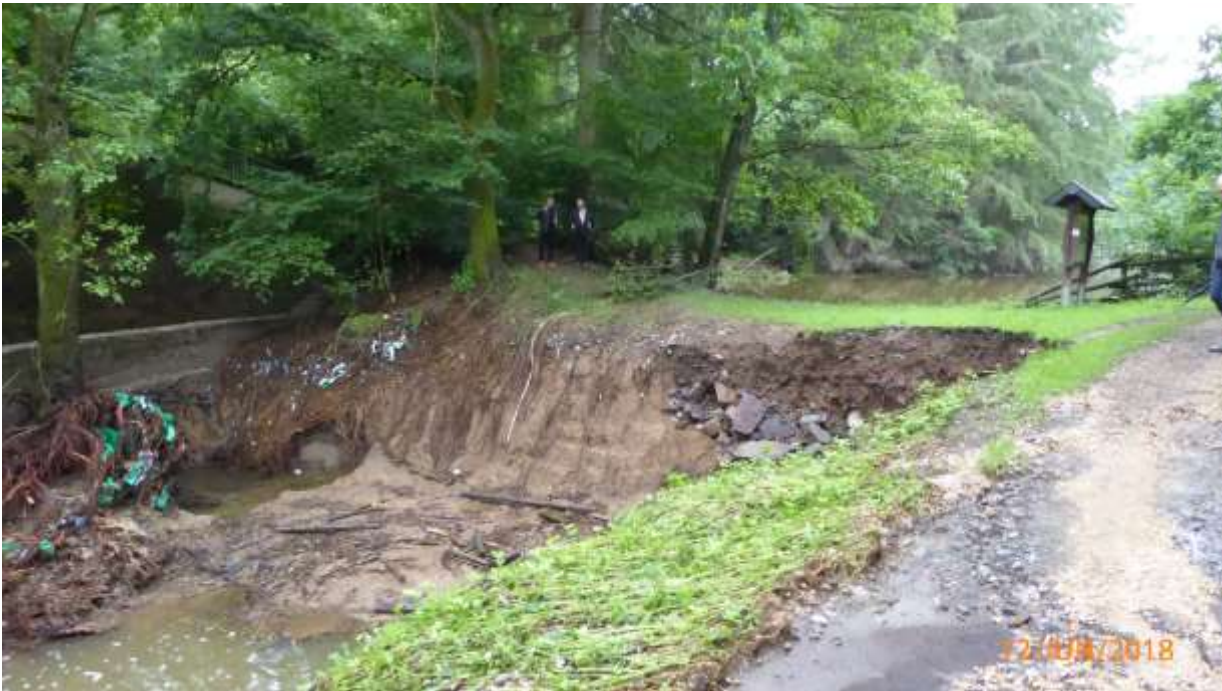
Abbildung 16: Schäden im Eifelzoo bei Lünebach (Copyright: Kreisverwaltung Eifelkreis).
