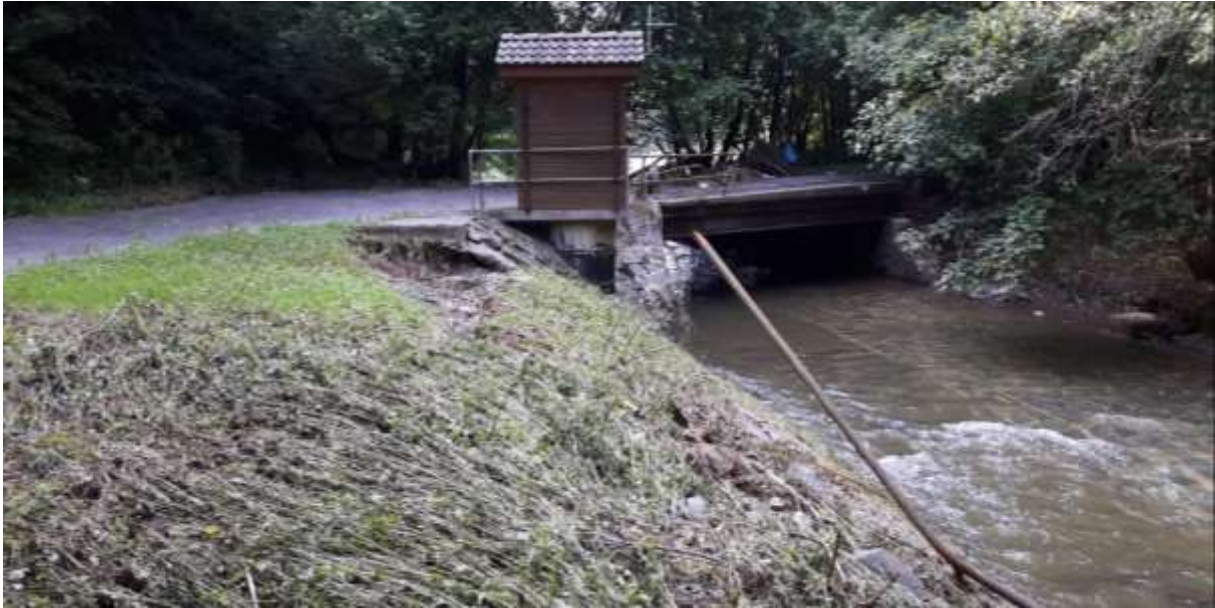
Abbildung 10: Pegelstation „Gerach“ am Fischbach nach dem Hochwasser (Copyright: LfU).
